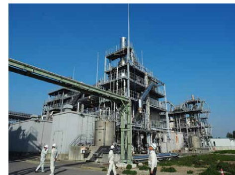
95t/日の能力を持つ汚泥焼却施設
