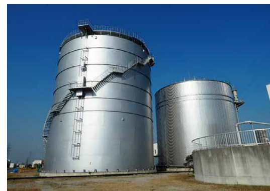
鋼板製消化タンク（右）とガスホルダー（左）。 消化タンクの有効容量は5,800m 3 で建設当時は最大規模
