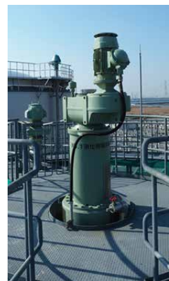
タンク上部約19mの高さにある攪拌機
