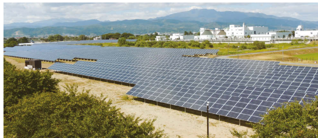
写真－1 太陽光パネル
