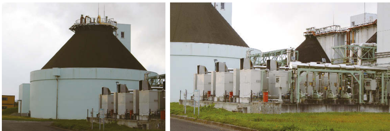
写真-3 山形浄化センターの消化タンク（左）と発電機（右）
