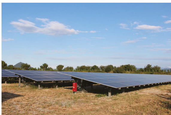
写真-1 設置されている太陽光パネル
