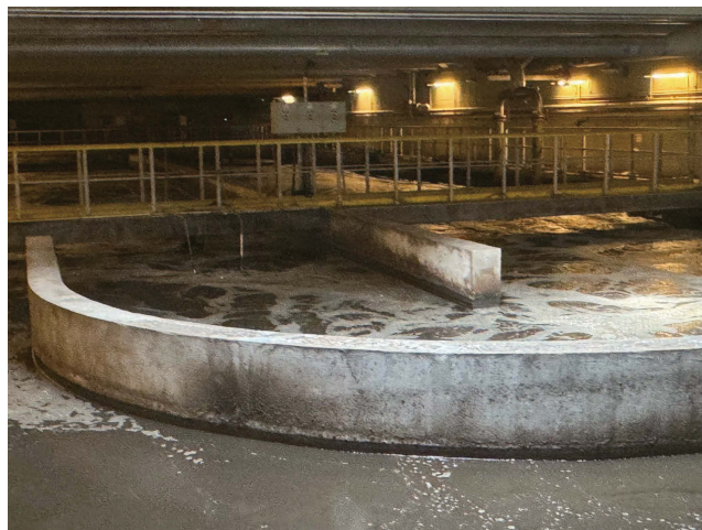
ブダペスト中央処理場の反応槽
