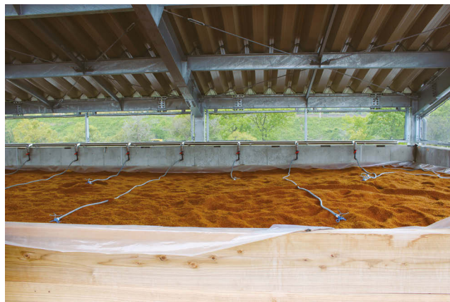
写真-1 薬品脱臭設備 (上), 生物脱臭設備 (下)
